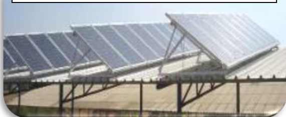
Protección de Paneles Solares
